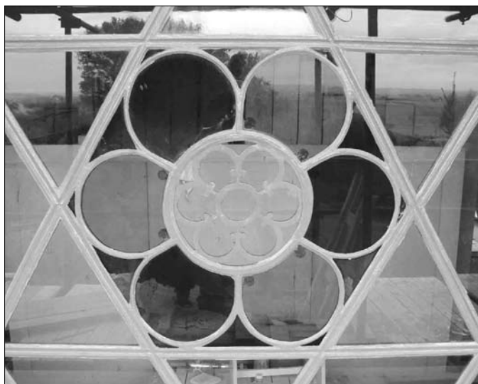
Stav po restaurování – rozetové okno – průčelí – vyčištěné a vyměněné tabulky skla (foto Vít Fogl, archiv autorky).
