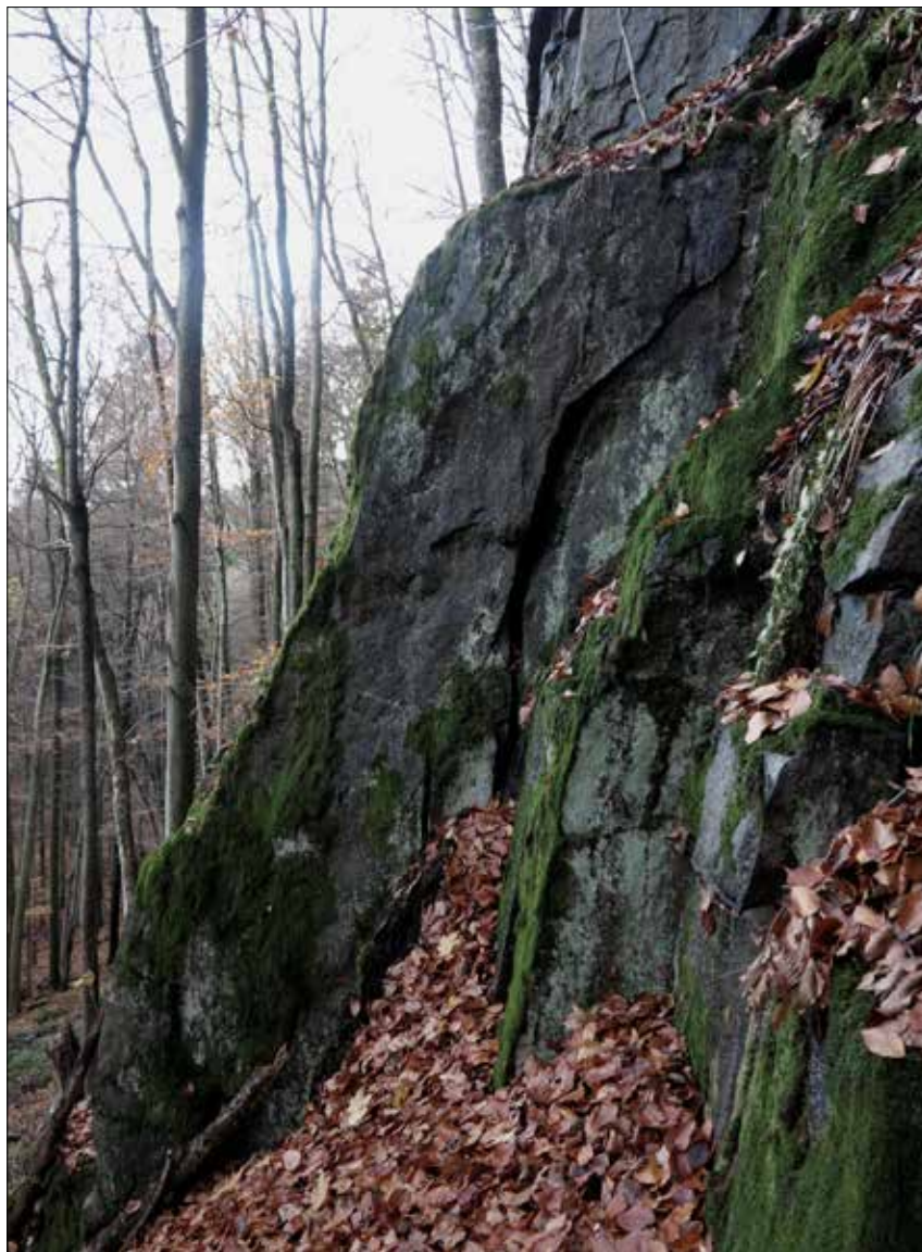
Obr. 7: Tahová trhlina rozšířená kongelifrakcí na čele mrazového srubu ve střední části Modlivého dolu.
