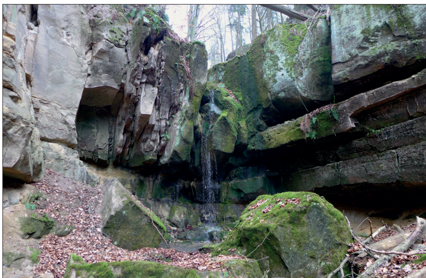
Obr. 19: Skalanský vodopád se vyznačuje silně rozpukanou stěnou.
