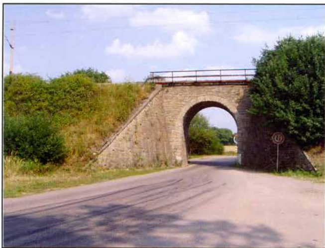
Obr. 7: Hnízdiště břehulí říčních v otvorech železničního mostu u Klenovic (TA), 5.8.2003. Foto 1–7: P. Heneberg (k článku na str. 3).
